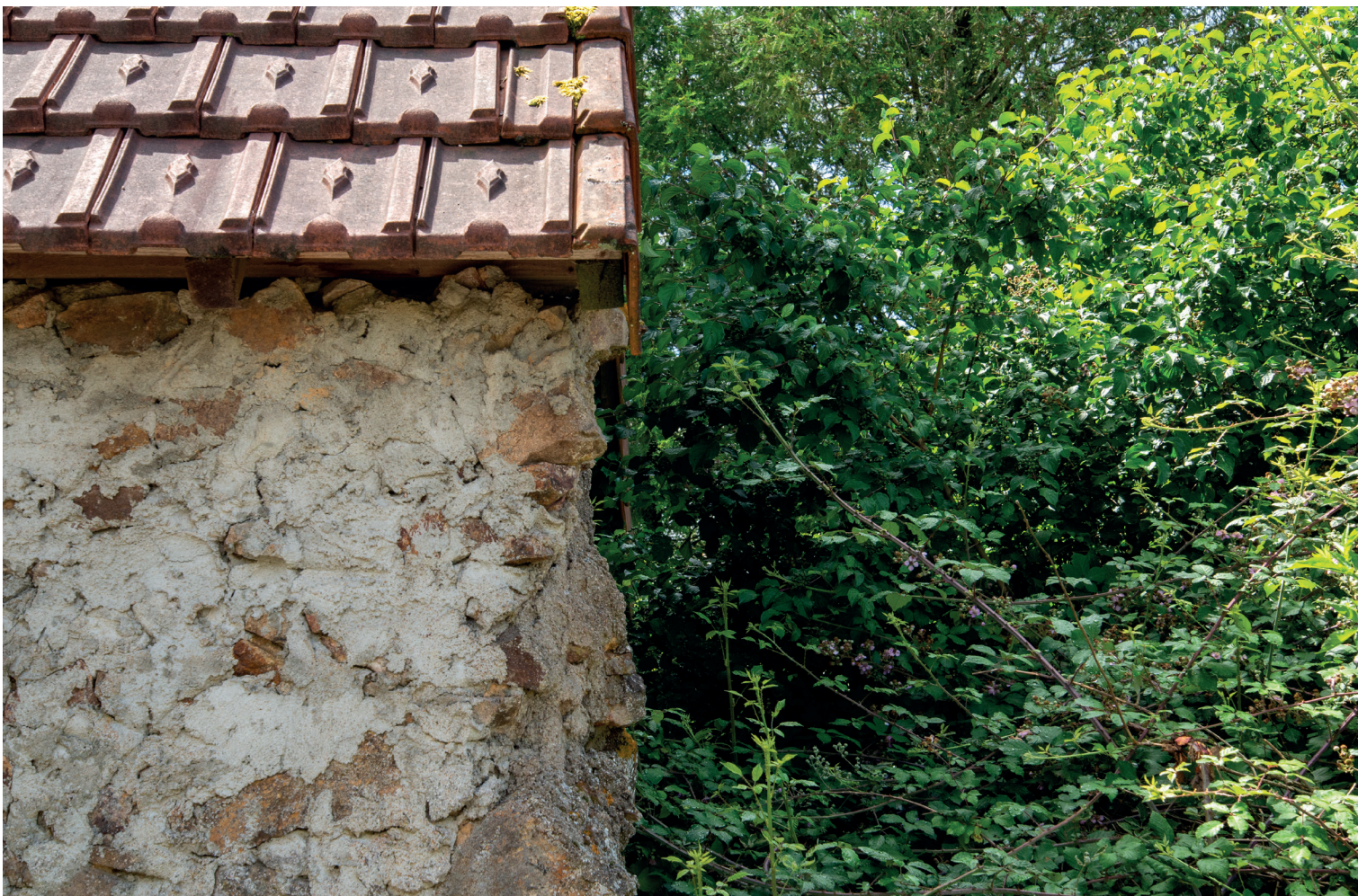
Détail de logement vétuste, Montcharlon (Chiddes)
