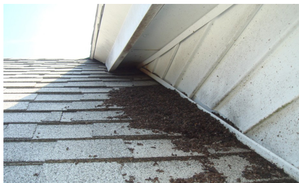
Fig. 66: Aperçu du guano des chauves-souris nichées dans la corniche
