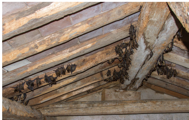
Fig. 72: Colonie installée dans les combles
