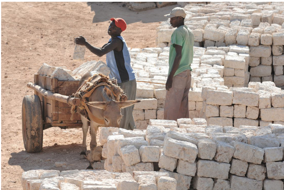
Extraction de la pierre de corail, photographie réalisé Antoine Lorgnier, 2014
