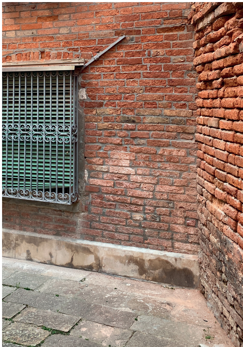
Fig 21: Efflorescence saline sur un mur en briques
