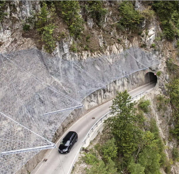
Fig. 16 ↑ Filet de protection et tunnel sur la route Chalais-Vercorin ©Geobru gg
